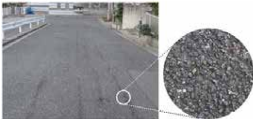
老朽化による荒れ▲
