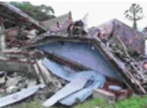
大地震で崩壊した民家。逆解析で大地震が起こっても崩壊しない家を設計する
