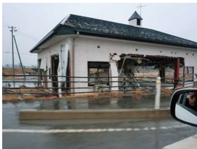
東松島市鳴瀬川河口部 津波により道路沿いの商業施設が破壊されているが津波高より高かった屋根だけは残っている。
