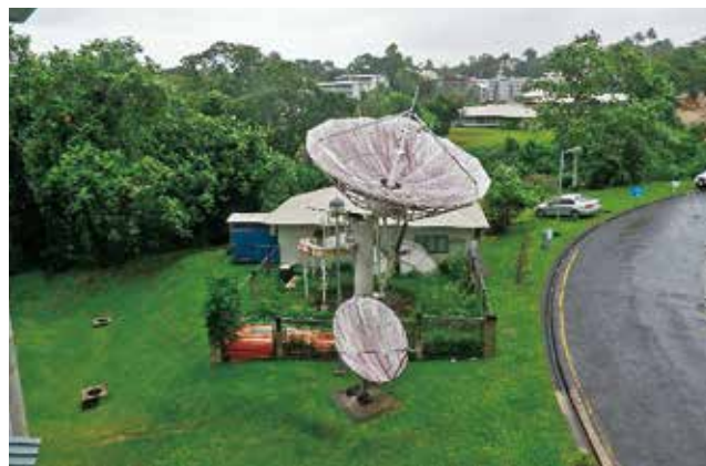
南太平洋大学の各キャンパスを結んで授業を行うためにわが国の協力により設置された衛星放送施設
